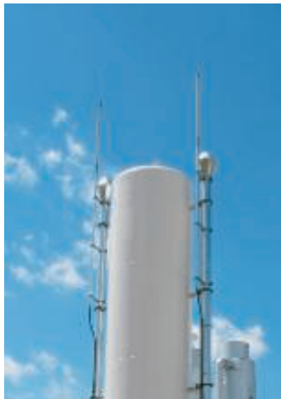
Sistemul isCon® din zona de evacuare a unei centrale de biogaz
