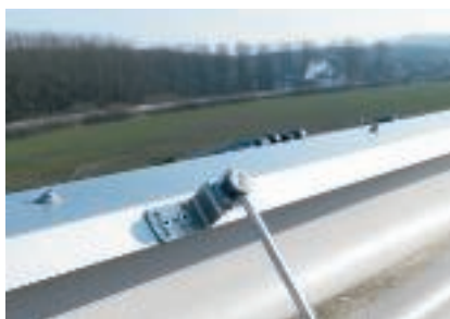
Un zid parapet legat la sistemul de protecție împotriva loviturilor de trăsnet
