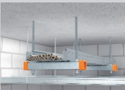
Montaj pe tavan într-un singur strat în partea de sus a tavanului de protecție la foc suspendat.
