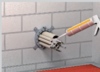
Închiderea capetelor țevilor cu modelator de strat izolant DSX.
