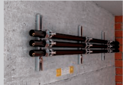
Instalarea alăturată a mai multor țevi, cu economie de spațiu, folosind bride.
