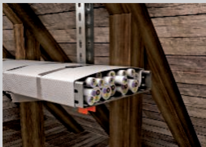
Sisteme de susținere a caburilor bandajate cu foarte multe materiale inflamabile.
