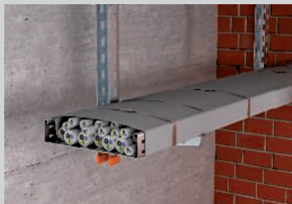
Învelirea completă a unui canal de cabluri suspendat.
