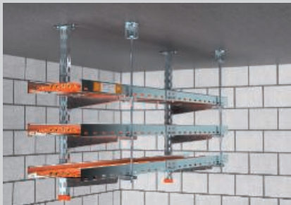
Suspendarea capacului cu dispunerea pe o singură parte a consolei.
