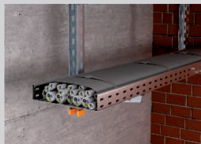
Bandajarea mănunchiului de cabluri pe sisteme de susținere.
