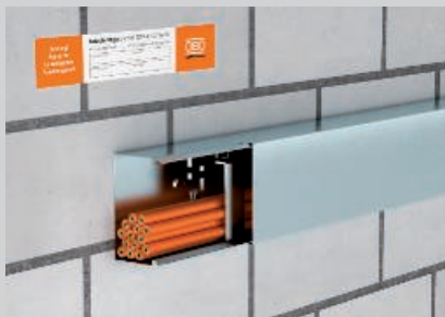
Pozarea cablurilor de putere, de date sau de semnalare a incendiilor în canal tip LKM60100.
